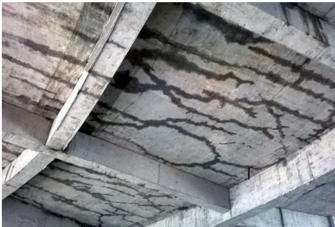
楼面因混凝土收缩开裂
